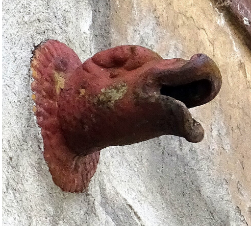
1. Odpływ wód opadowych z balkonu domu przy Sikorskiego 19 (fot. Zb. Januszaniec).
